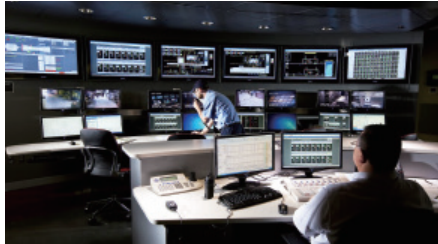
KOMUTA KONTROL MERKEZİ
